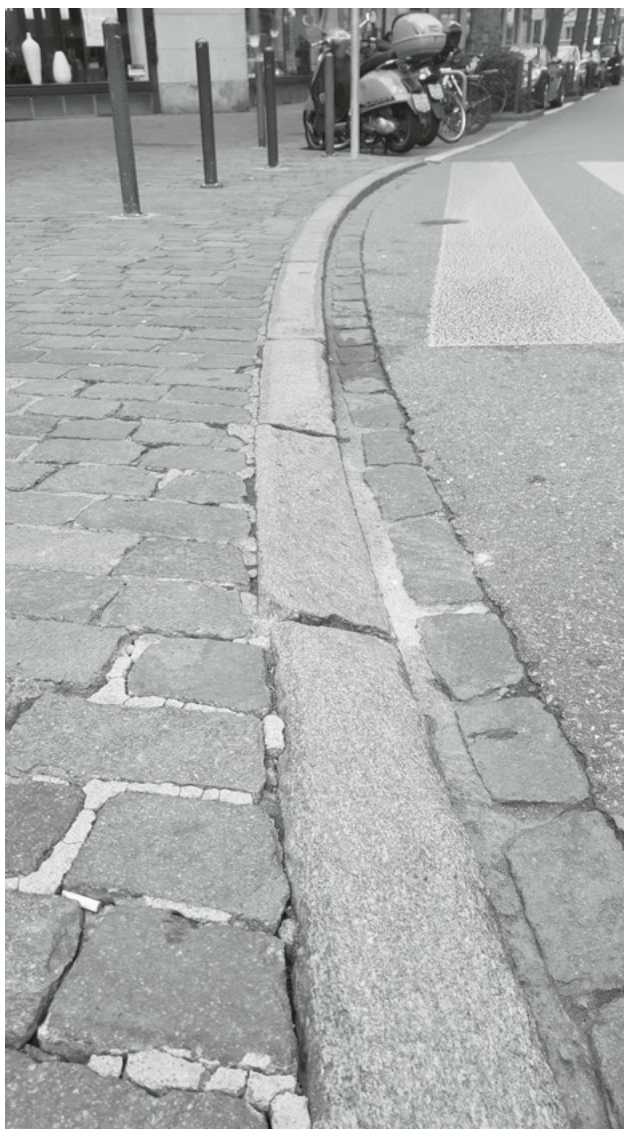
Kleine Massnahme – grosse Wirkung: Randsteinabsenkung erleichtert die Durchfahrt. (Bild: TAZ)
