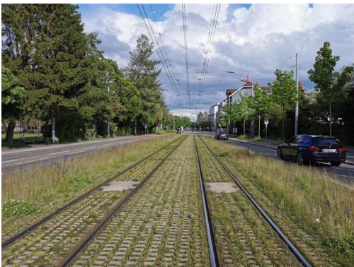
Abbildung 3: Rasengittersteine bei der Haltestelle «Grimselstrasse». (Bild: VBZ)
