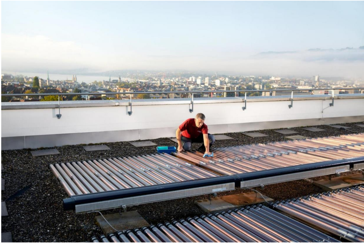
Bild 20: Thermische Solaranlagen, hier auf dem Dach der SAW Siedlung Scheuchzerstrasse, betreibt die SAW bereits heute. Ab 2024 werden diese mit Photovoltaik-Anlagen ergänzt.
