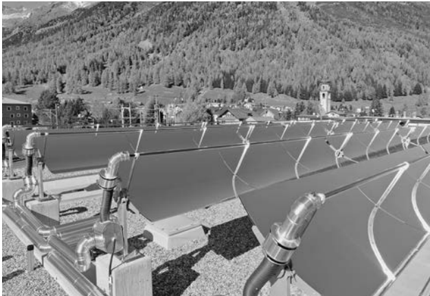
Hochtemperatur-Solaranlage auf dem Dach der Lesa. (Bild: ewz)
